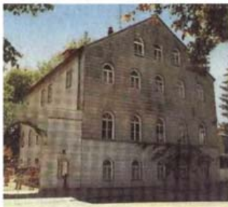
Vor der Sanierung: Das Schlösschen mit seiner tristen Eternit-Verkleidung.
